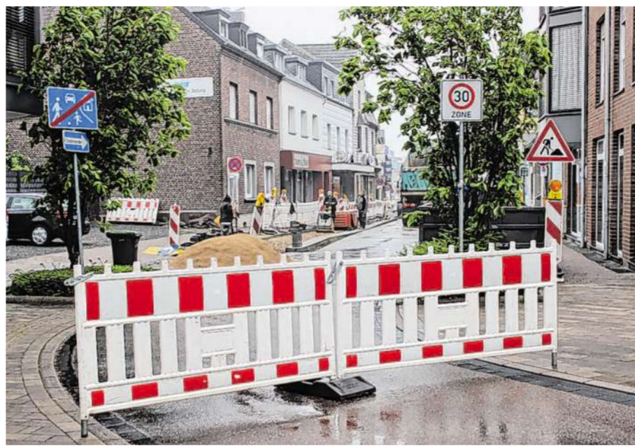
Der obere Bereich der Kückstraße ist gesperrt.
